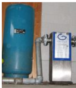
GRANDER enhed placeret umiddelbart efter pumpestation hos DYKON A/S
